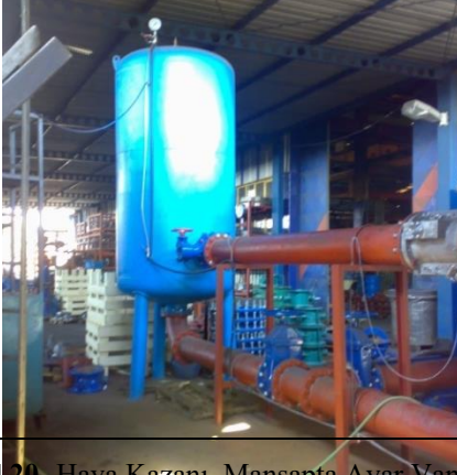
Şekil 20- Hava Kazanı, Mansapta Ayar Vanası ve Manometre/Basınç Sensörü, aşağıda Deşarj Vanaları.
