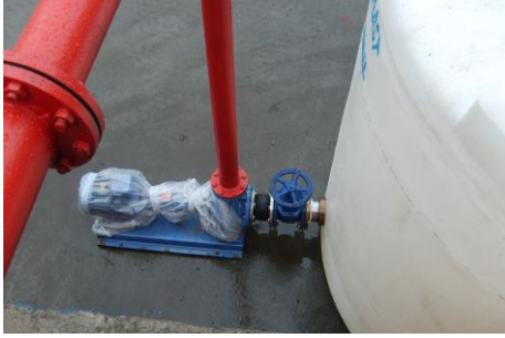
Resim 2- Depo ve Pompa Sistemi
