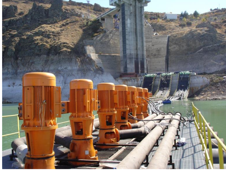
Resim 7- ASKİ Çamlıdere Sal Üstü Pompa İstasyonu
