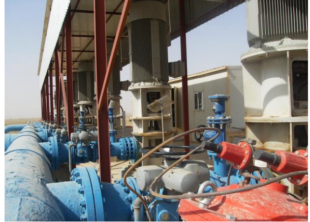
Resim 6- Açık Alan Bir Pompa İstasyonu Örneği, Dibis- Irak (Q = 220 l/s – 240 m – 630 kW – 1450 d/d)
