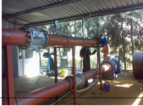
Şekil 21- Yatay, Santrifüj, Norm Üstü Pompa, Membada Ayar Vanası ve Manometre/ Basınç Sensörü, Debimetre.
