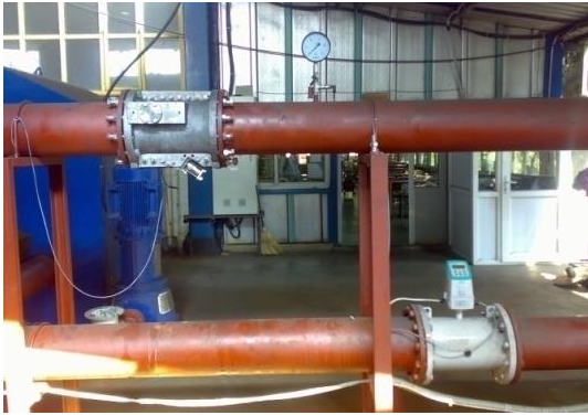
Şekil 18- Test Vanası, Membada Manometre ve Basınç Sensörü, Debimetre.
