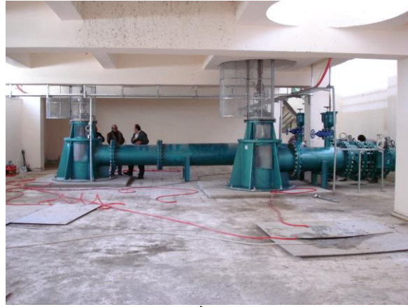
Resim 4- Kuzova Pompa İstasyonu Pompa Katı
