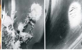
Resim 3. Kaviteasyon ve hasar oluşumu.
