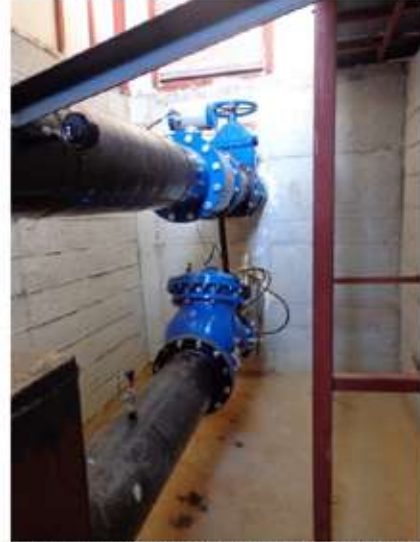
Şekil 7. PaT ve PRV sisteminin bulunduğu boru sistemi
